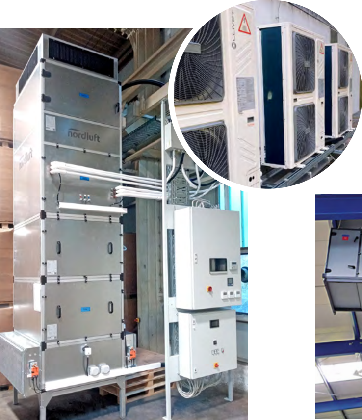
Wärmepumpenheizung (3-fach Kaskade) mit Stromdirektheizung zur Spitzenlastabdeckung
