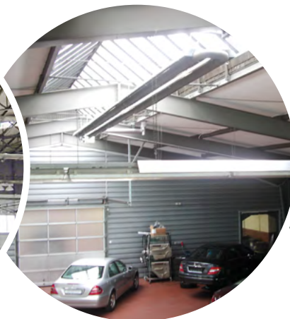
Beheizung einer PKW-Werkstatt
