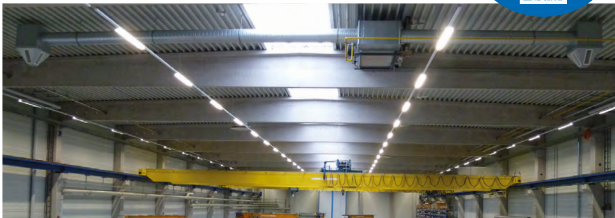
Feinmechanikproduktion: Beheizung mit Weitwurf-Ausblasköpfen. Wärmerückführung mittels Deckenventilatoren.
