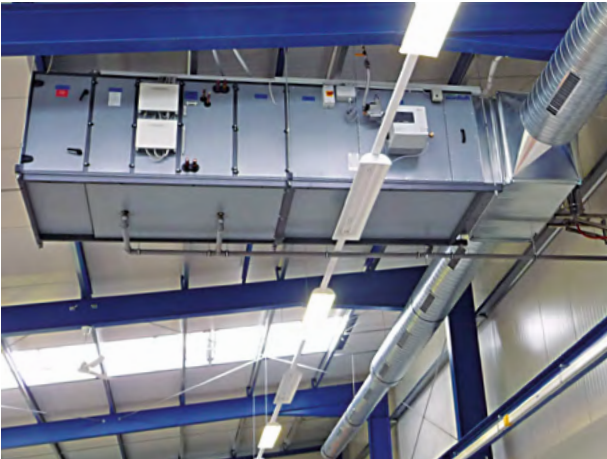
Beheizung eines Automationsbetriebes. Kühlfunktion vorbereitet (Leerteil).
