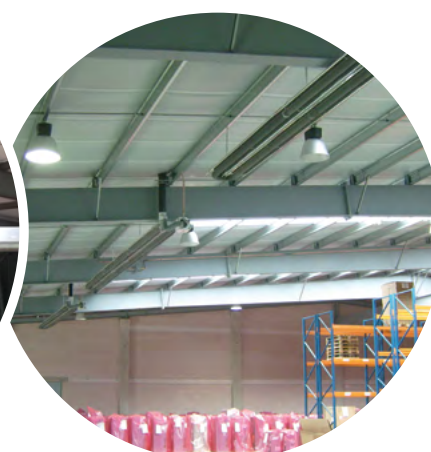
Zonen-Beheizung eines Kommissionierbereiches in einem Speditionslager
