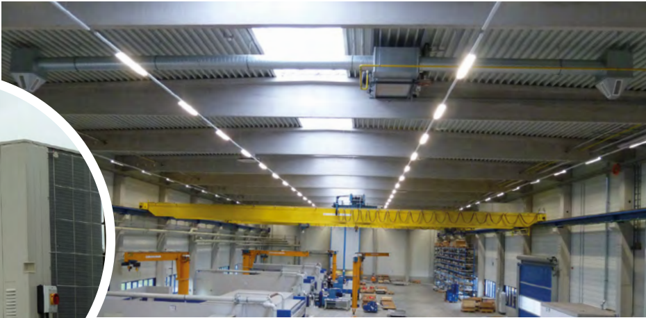
Beheizung und Belüftung einer Vorwärmhalle für Aluminium-Blöcke, Fa. Airbus. Decken-ventilatoren zur Wärmerückführung.
