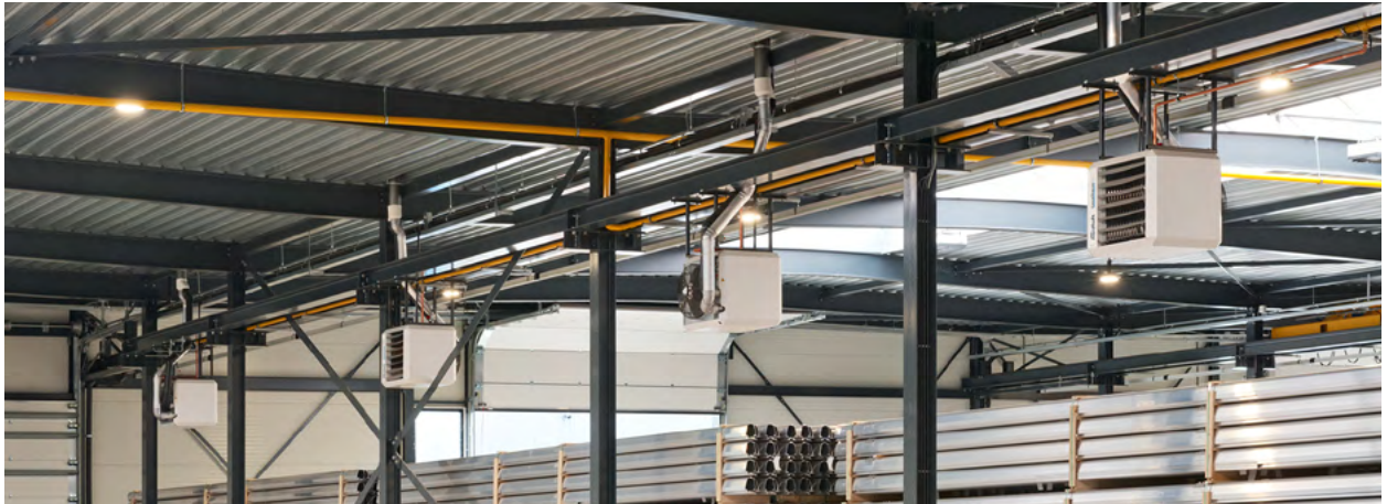
Beheizung Produktionshalle mit Lagerbereichen
