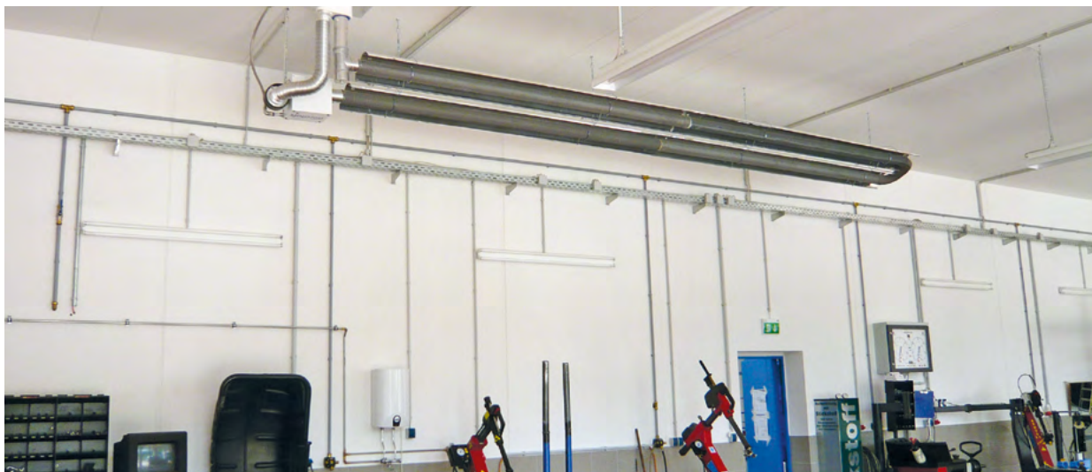
Zonen-Beheizung in einer PKW-Werkstatt
