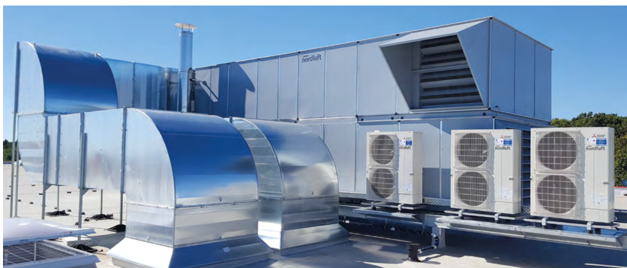
Beheizung, Kühlung und Belüftung eines Möbelmarktes. EcoKomfort (44.000 m 3 /h) mit Wärmerückgewinnung.
