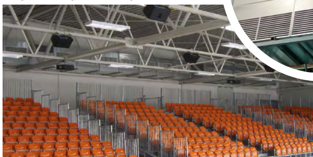
Auktionshalle: Permanent-Beheizung und -Belüftung (Dauerlüftungsbetrieb).
