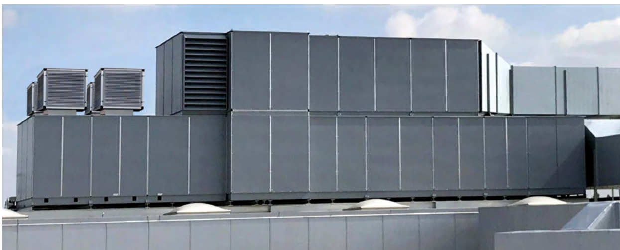
NL-VK als Vorkühlung für eine Lüftungsdachzentrale
